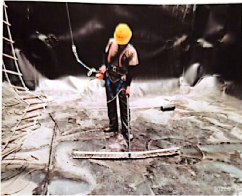
图 3-2 单元池底部渗漏探测现场
