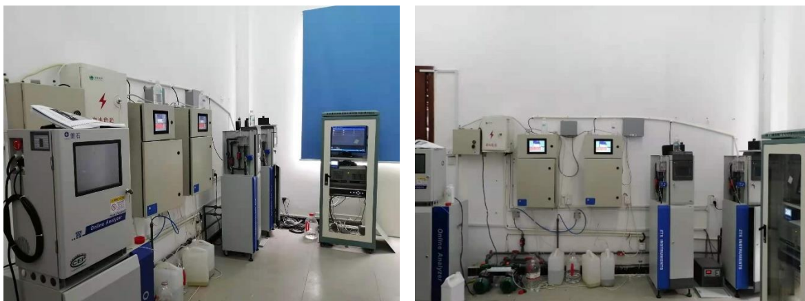
图 4-4 废水在线监控设备
