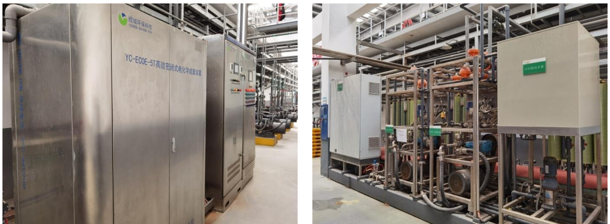
图 3-32 电絮凝及两级 DTRO 装置
